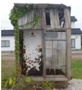
放置されたキュービクル
